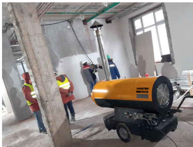
Secado de obras BV 400
